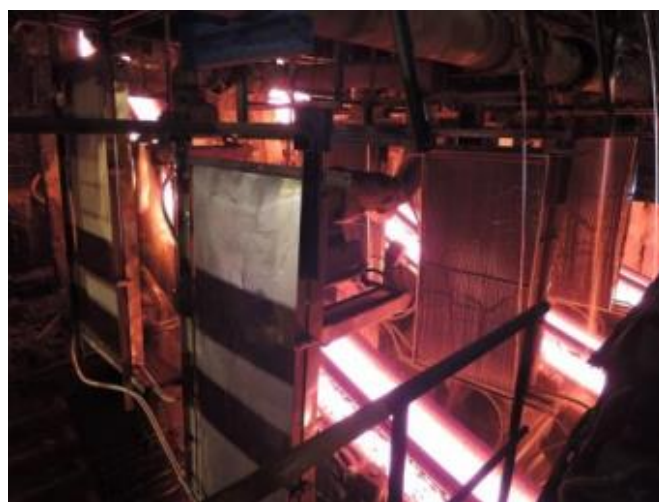
圖 25、鋼鐵熱輻射廢熱回收熱電發電系統
