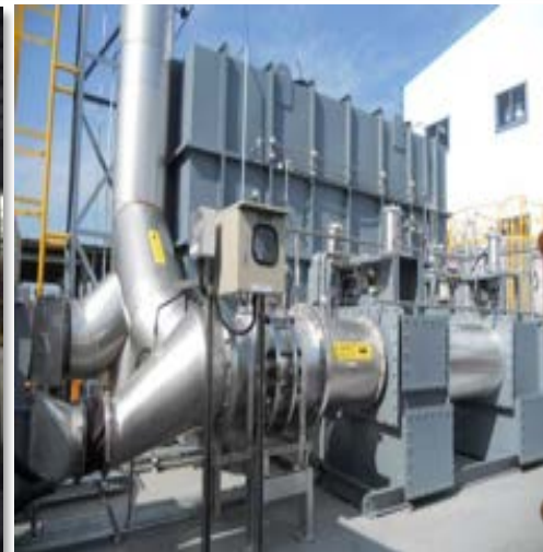
蓄熱式焚化爐DeVOC設備
